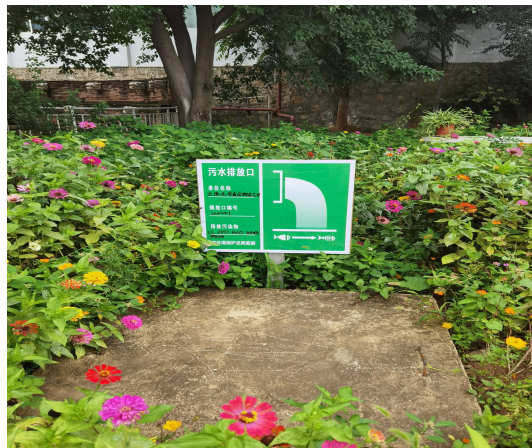
厂区污水总排口
