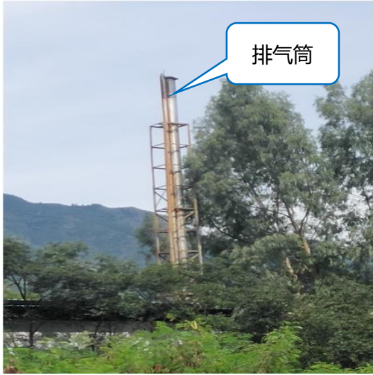
油烟净化排气筒
