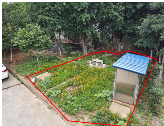
污水处理设施
