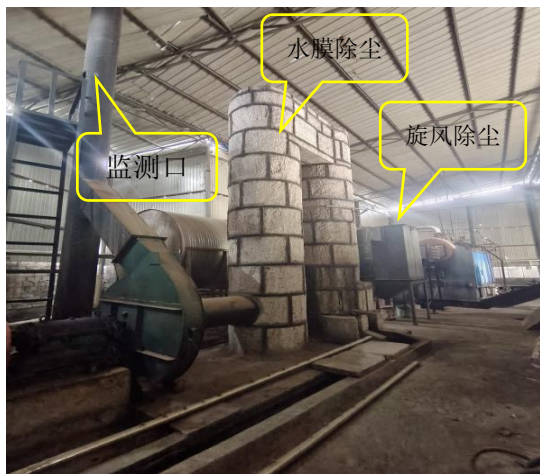
废气处理设施
